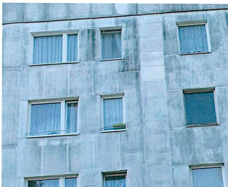
Fot. 2 Płyta azbestowa płaska stosowana w budownictwie na przykładzie bloku mieszkaniowego w dużym mieście wojewódzkim.
