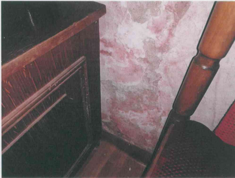
Zdj. 7 Widok zawilgoconej ściany – zakrystia.
